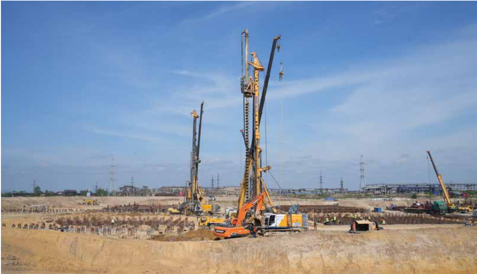
Новая тепловая электростанция в Усолье-Сибирском станет первым крупным объектом генерации, построенным в Приангарье за последние полвека
